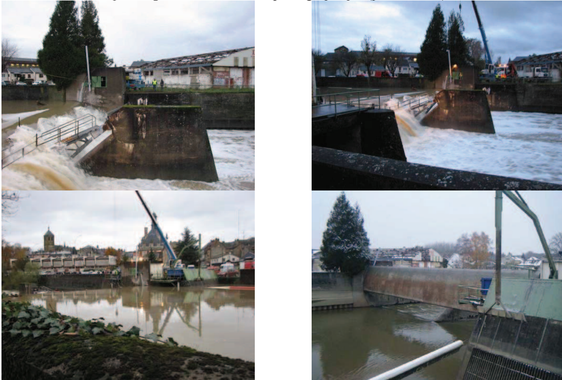
Photos 1 à 4 : Surverse du barrage de Rehel, mise en place des grues pour ouvrir la vanne (09/11/2010) et état de l'aménagement à l'issue de l'intervention (Crédit photos : DREAL Champagne Ardenne)
